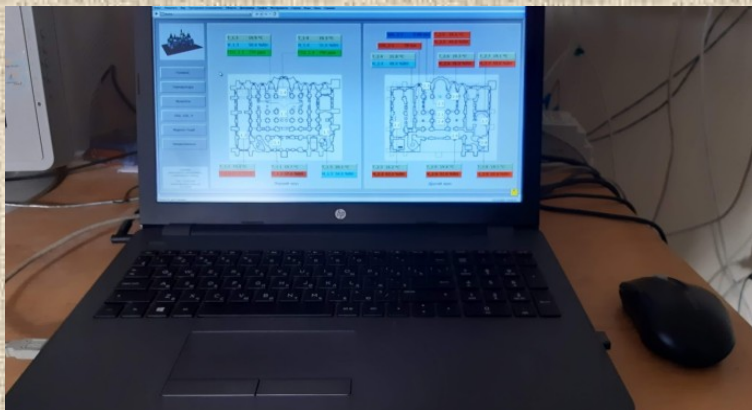
Сервер системы контроля микроклимата (Hewlett Packard), система SCADA IGSS (Schneider Electric), прикладное ПО (СОЛІТОН)
